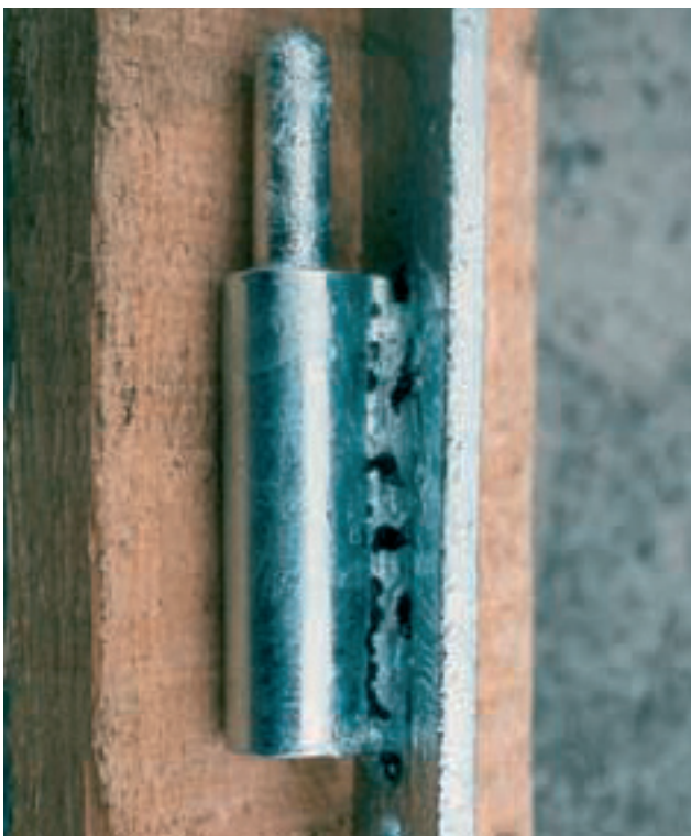
En hyppigt forekommende fejl på varmforzinkede emner. Mangelfuld afrensning af svejseslagge før varmforzinkning.
