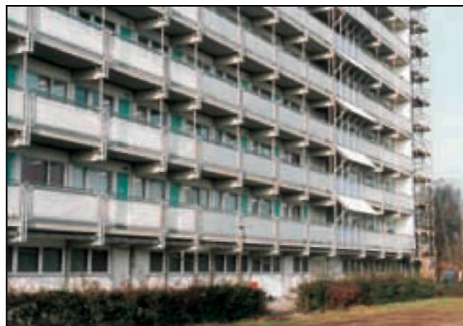
Varmforzinkede altanrækværker i højhusbyggeri.
