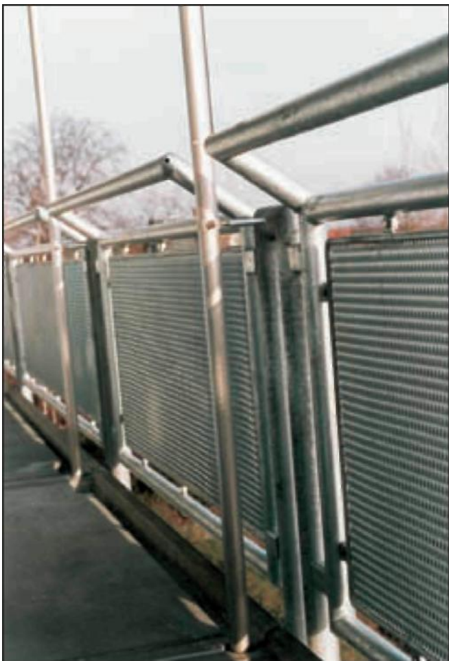
Varmforzinkede altanrækværker i højhusbyggeri.
